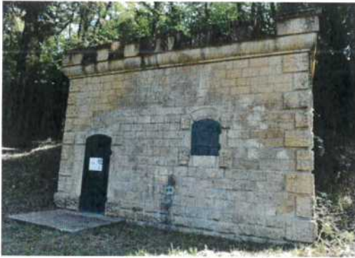
Une des sources du captage de la Vallée de Montvaux
