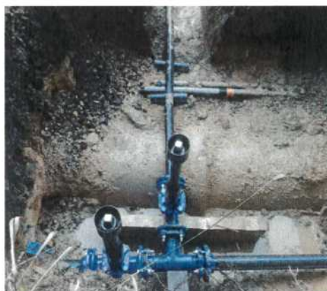
Branchement Allée du Bois
