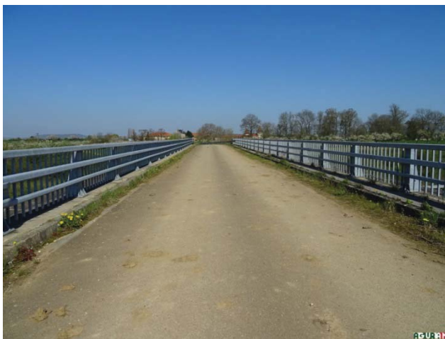
> Rupture au niveau de la RN 431 (Basse Bévoie); l'absence de végétation en bordure de la route n'est pas favorable au déplacement de la faune
