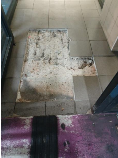
Figure 1 – Carrelage au sol qui se décollait
