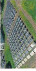
La première centrale photovoltaïque installée sur le territoire de l'Eurométropole implantée au 11 rue Tolhaud de Chardin à Metz, derrière le centre technique de la Ville de Metz. Grâce par JEM, elle est destinée à alimenter en électricité des bâtiments municipaux et métropolitains et éviter l'émission de près de 500 tonnes équivalent de CO2 sur la durée de fonctionnement
