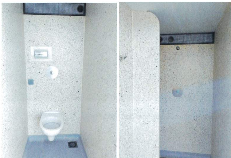
WC/douche présent dans les nouveaux modules sanitaires
