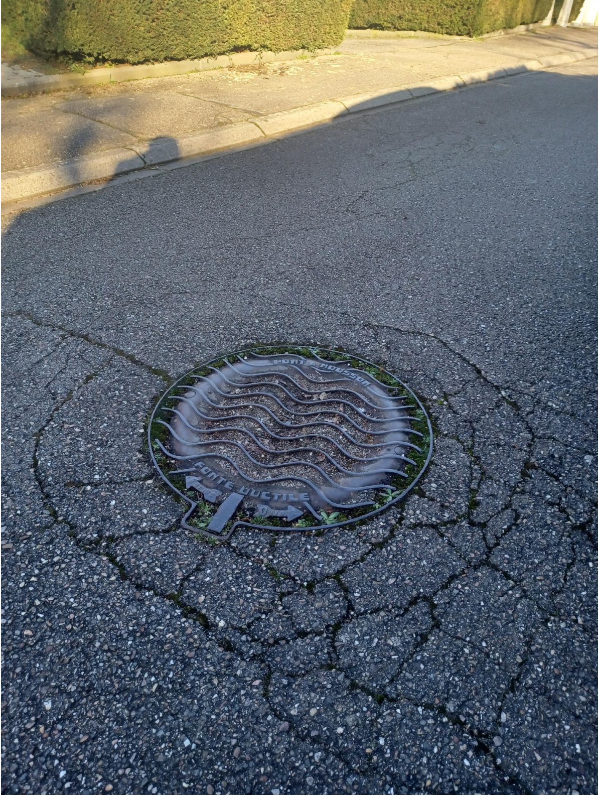
Réseau eaux – plaque d'égout
