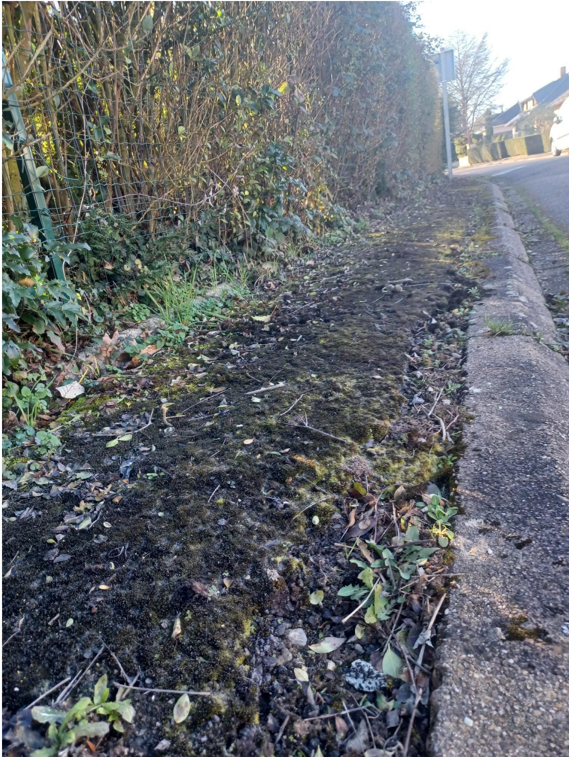
Dégradation trottoirs Largeur des trottoirs non réglementaire (entre 50 cm à 70 cm)
