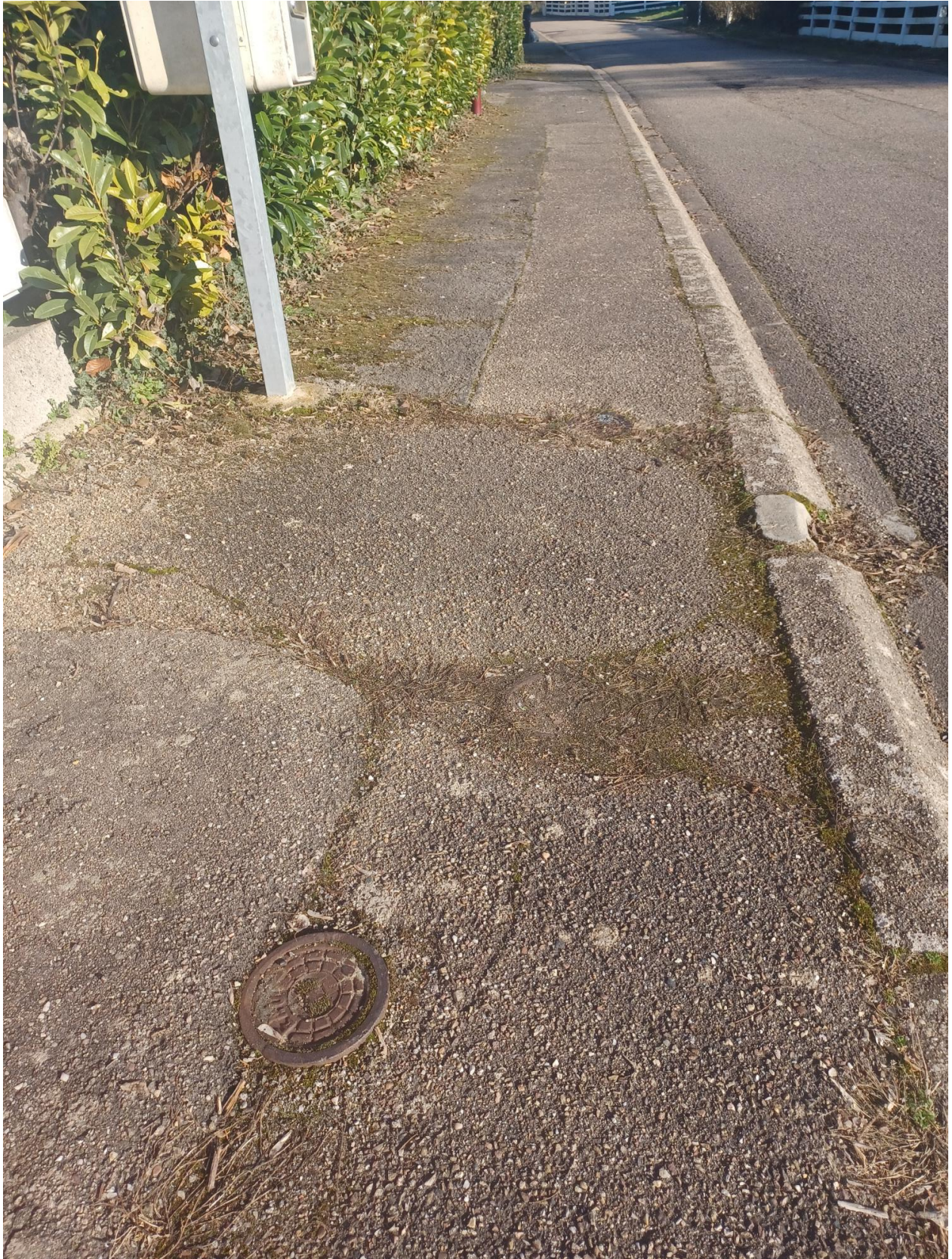
Réseau eau potable – Bouche à clé
