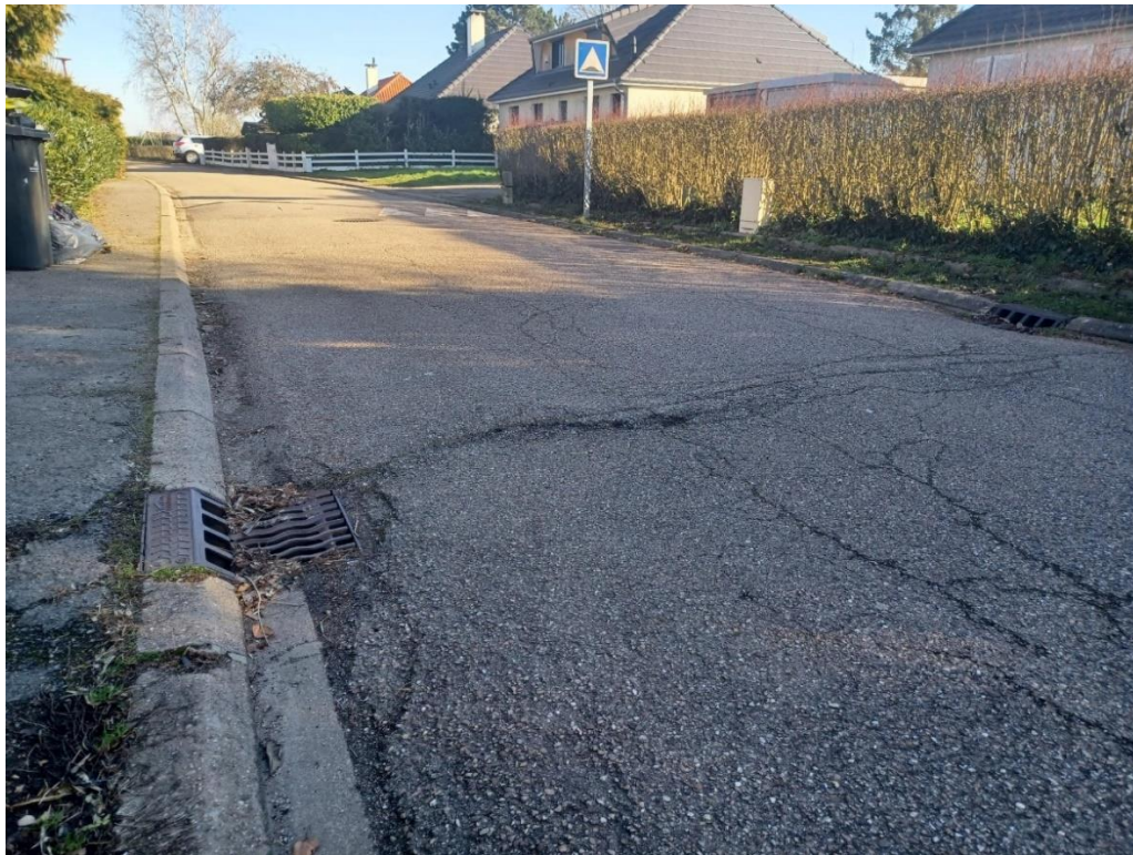
Avaloir – Réseaux d'assainissement / Eaux pluviales
